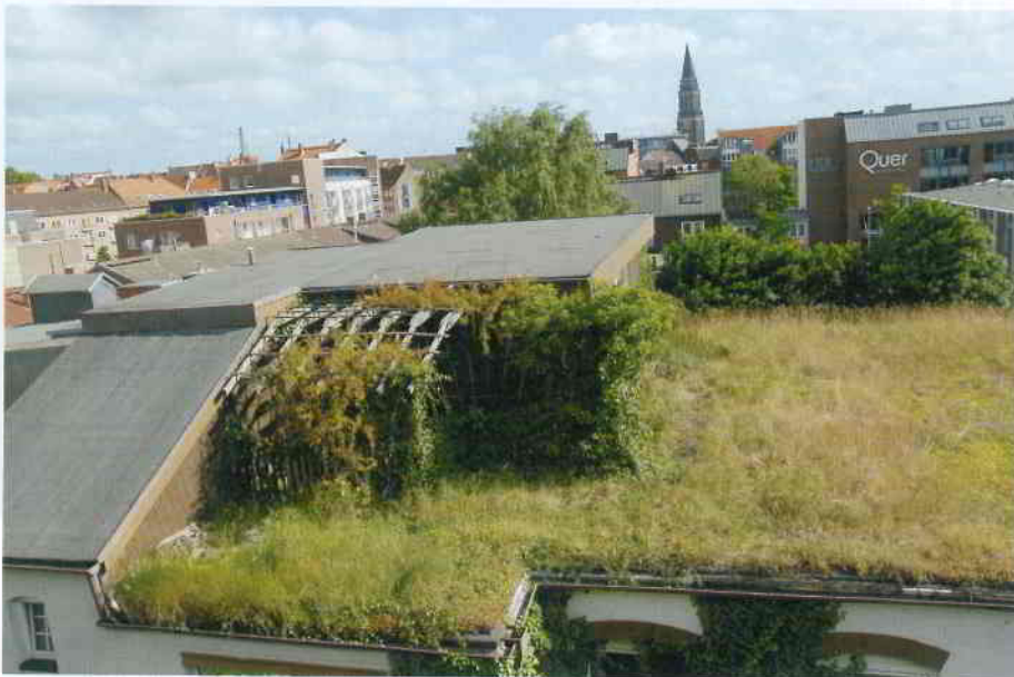
Das Dach in der Lerchenstraße in Kiel im Juni 2009. Seit Jahrzehnten sich selbst überlassen. Aus Sicherheitsgründen – wegen fehlenden Geländers – ist der Zugang verschlossen.
